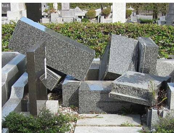
【倒壊したお墓の被害状況】 角地近辺墓所、前面が通路、背面が傾斜が大きい法面地震の揺れが全体的に大きく伝わったと思われる。
